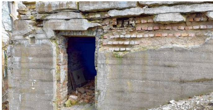
Hier sieht man, wie groß der Sanierungsbedarf im Sockelbereich des Gebäudes ist.
