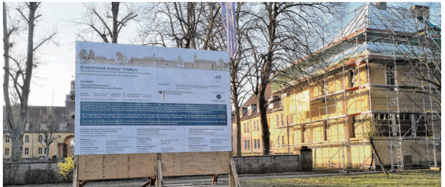
Der Startschuss für die Bauarbeiten an der Europäischen Schule Templin ist gefallen. Mitte Mai sollen die Arbeiten wieder Fahrt aufnehmen, und der nächste Bauabschnitt wird schon vorbereitet.
